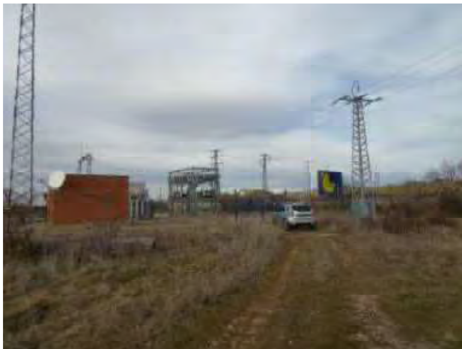
Figura 8. Fotografía realizada en la subestación de Riaza en febrero de 2022. Fotografía propia
