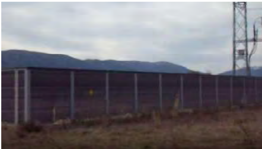
Figura 12. Fotografía realizada en la subestación de Prádena en febrero de 2022. Fotografía propia
